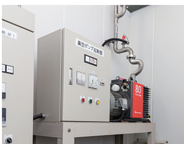
真空ポンプ起動盤
